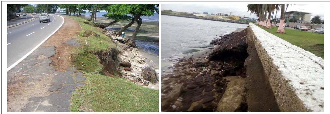
Planche : dégradation du boulevard du bord de mer à Libreville
